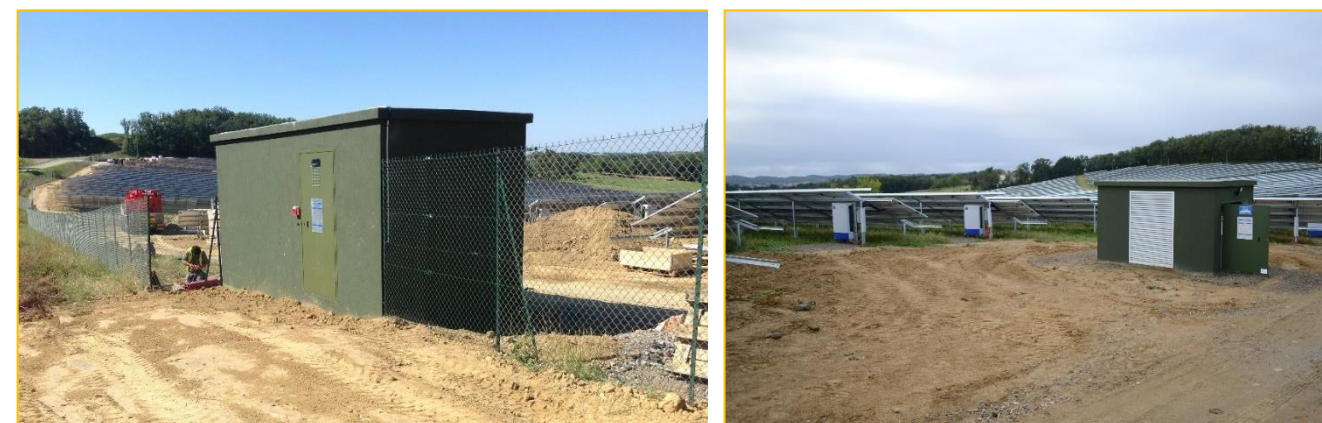
Photographie 29 : Exemples de poste de livraison et transformation de couleur verte
