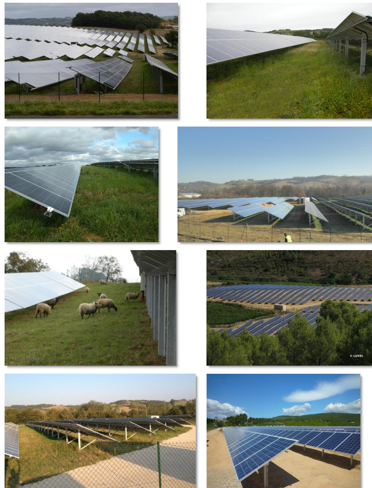
Photographie 5 : Exemples de parcs photovoltaïques de Luxel
