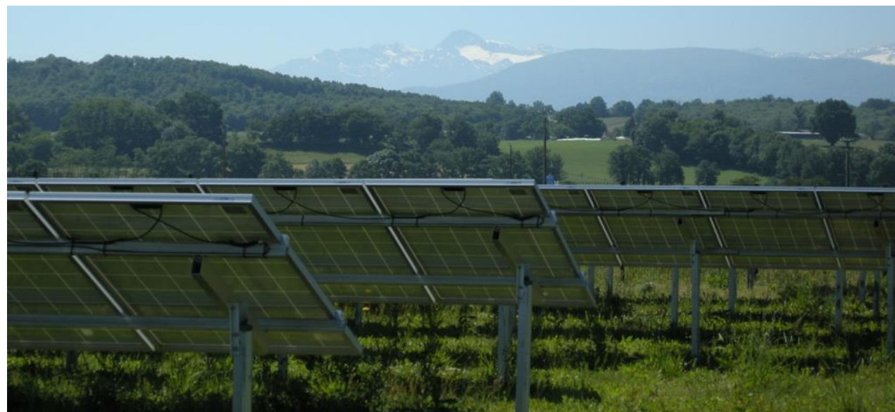
Photographie 1 : Parc solaire photovoltaïque de Saint-Martory (31) (Source : Luxel)
