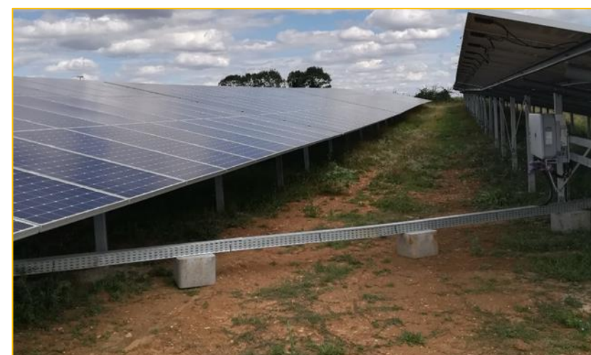
Câbles hors sol – source : LUXEL
